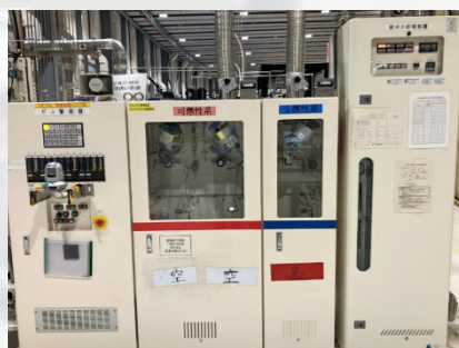
ガス取扱設備（共通設備） ガス雰囲気を試料に供給しながら計測を可能にする。ガスの供給と排気を安全な取扱いが可能
